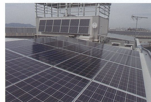
福岡（本社） 発電量：10kW
