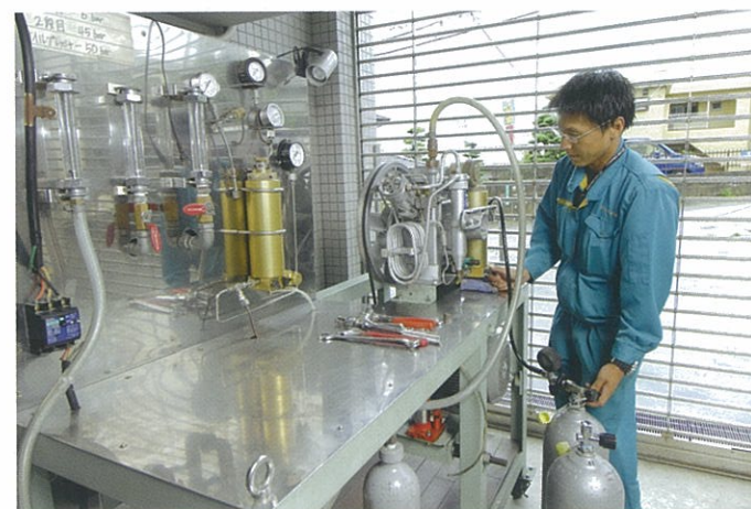
高圧コンプレッサー点検、試験架台（圧縮比、効率、リーク等）
