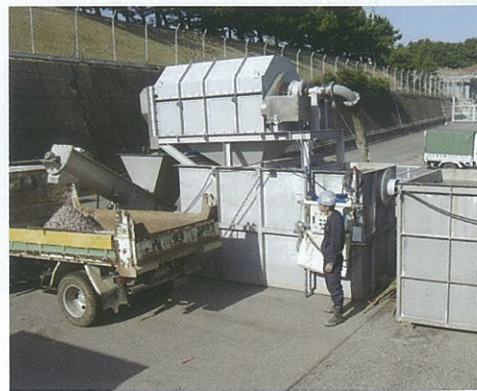
固液分離機 (II型) 稼働状況
